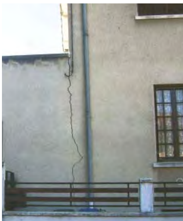
Figure 1 : Devant un désordre de cette ampleur, on emploie le terme « lézarde » pour qualifier la fissuration qui apparaît entre deux corps de construction.
