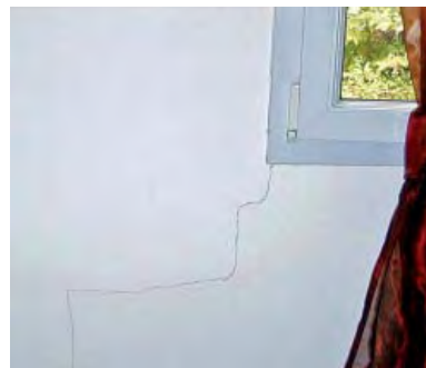
Figure 5 : Fissuration d'une cloison de doublage en briques. Si la façade est également fissurée au droit de cette ouverture, on peut conclure que l'on est en face d'un tassement.
